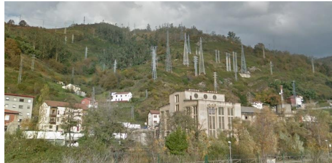
Montaña de Santa Cruz de Mieres, Asturias, pertenecientes a la subestación eléctrica Soto-Ferreros
