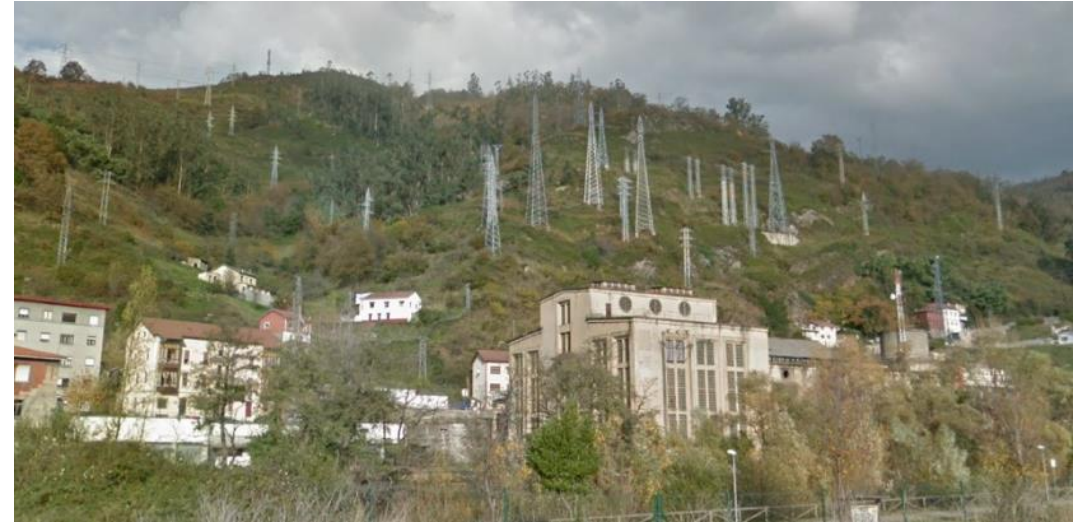
Montaña de Santa Cruz de Mieres, Asturias, pertenecientes a la subestación eléctrica Soto-Ferreros
