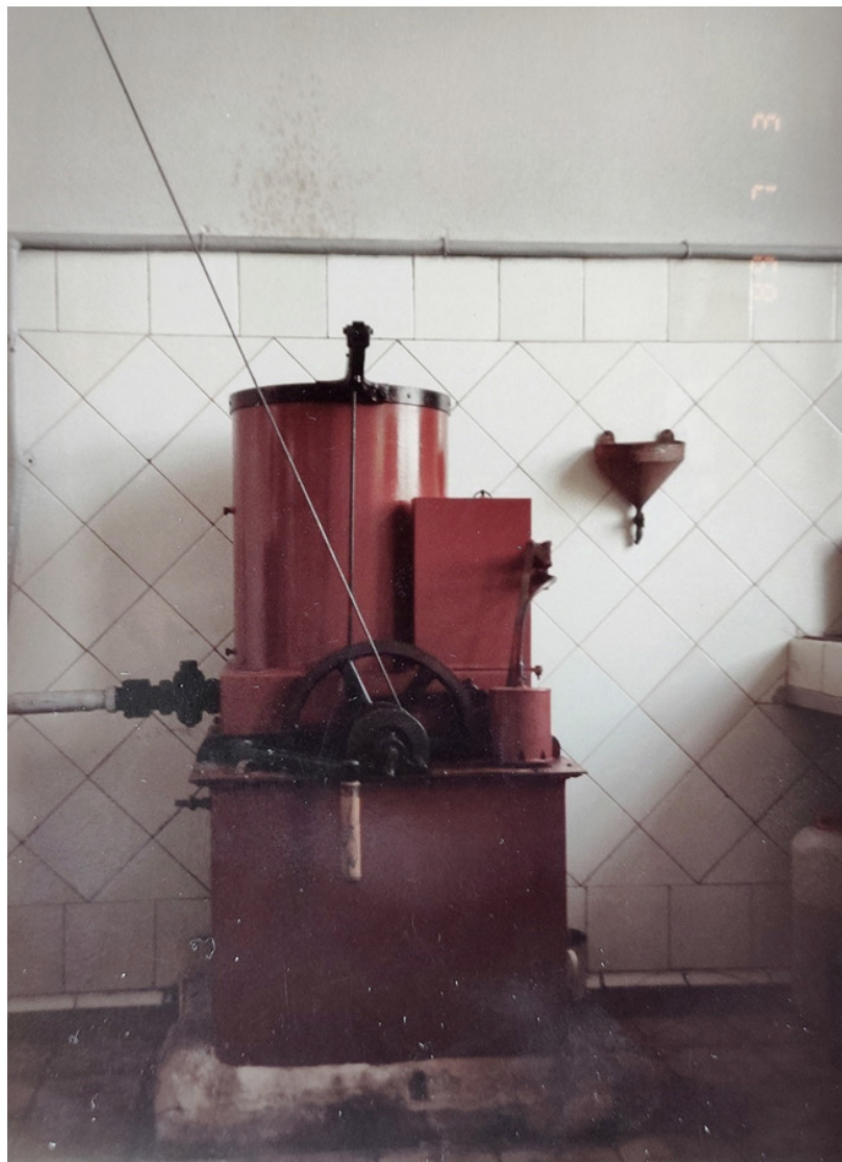
Gasógeno de presión en su emplazamiento original. Laboratorio de Bacteriología. Hospital del Rey
